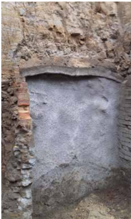
Obr. 3 Zazděné sklepení s porušenou klenbou
